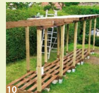
10 Anschließend werden Schalbretter in Sparrenlänge oben aufgelegt und mehrfach mit den Sparren verschraubt.
