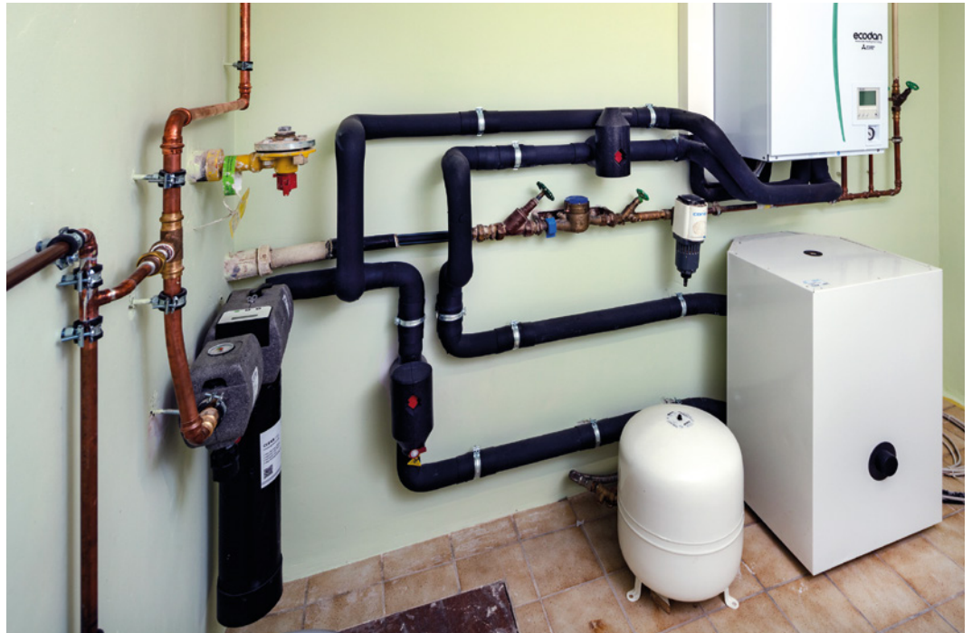
Im Technikraum steht ein kompaktes Hydromodul mit anschlussfertigen Komponenten sowie ein Speichermodul als Pufferspeicher zur Verfügung.
