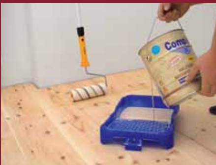
11. Nun wird die staubfrei abgesaugte Oberfläche mit einem optimal auf Zirbenholz abgestimmten Holzschutzwachs zweimal behandelt.
