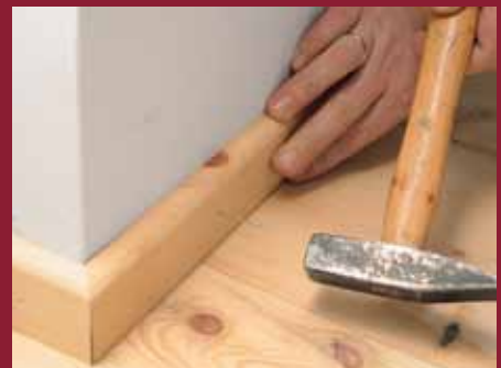
13. Nach Trocknung werden die ebenfalls mit Schutzwachs beschichteten Zirbenholz-Sockelleisten mit Stahlstiften an der Wand fixiert.
