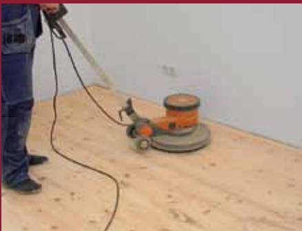
8. Im nächsten Arbeitsschritt erfolgt ein noch feinerer und gleichmäßigerer Schliff des Zirbenholzes mittels Tellerschleifer.
