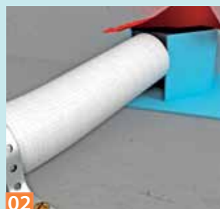
02 Das ebenfalls gedämmte Ablaufrohr fixiert man am Boden und deckt den Topf mit dem roten Schutzkleber ab.
