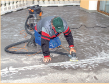
1. In einem Arbeitsschritt haben die Facharbeiter den freigelegten Terrassenestrich abgeschliffen und die Fläche komplett grundiert.
