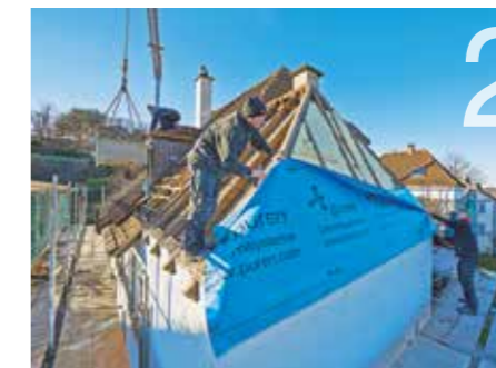
2 Es folgte die geradlinige, vollflächige Verlegung der Luftdichtheitsebene in Querrichtung von unten nach oben.
