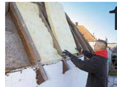
1 Nachdem die alte Eindeckung abgenommen worden war, dämmte man zunächst einmal die leeren Zwischensparrenräume.
