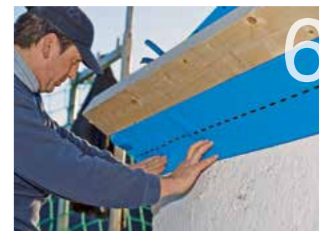
6 So sieht dann der saubere und dichte Anschluss an der Fassade aus. Ein neuer Traufbalken setzt die Folie zusätzlich fest.
