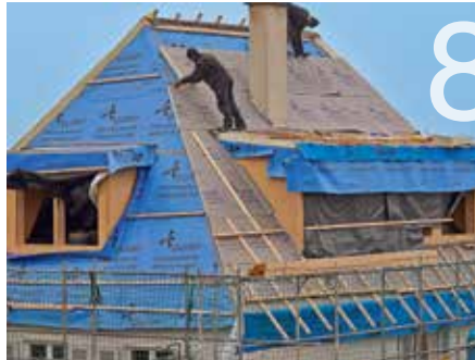
Auf einer Seite hat schon die Aufsparrendämmung begonnen. Die Konterlatten bilden zugleich den neuen Dachüberstand.
