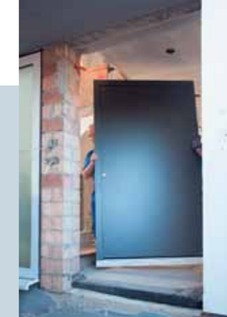
6. Dann kann die Zarge auch schon samt eingehängtem Türflügel in die neue Öffnung gestellt werden.
