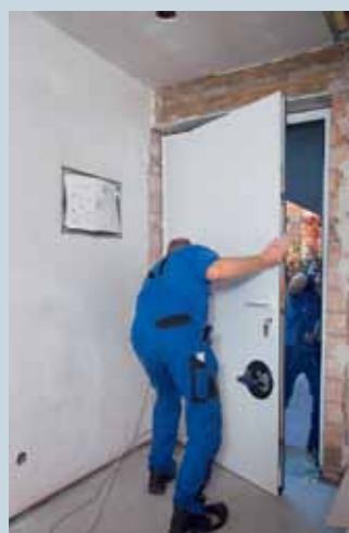
7. Die Tür wird dabei auch bewusst in eine bauphysikalisch vorteilhafte Einbautiefe platziert.
