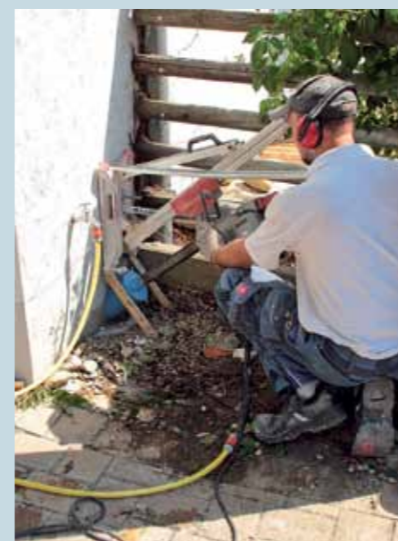
19. Den Weg frei für die Solarleitung ins Haus macht eine Kernbohrung von außen. Diese wird im 45-Grad-Winkel ausgeführt, ...
