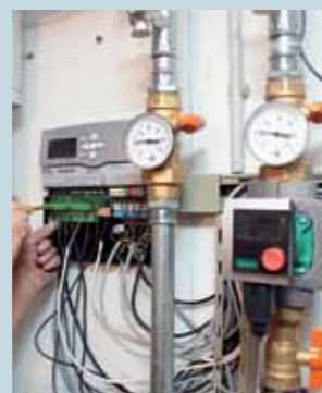
28. Der intelligente Schichtladeregler ist das „Gehirn“ der neuen Heizungsanlage.
