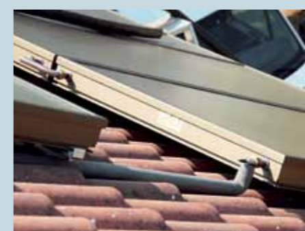
15. ... am Kollektor verschraubt. Bei Temperaturen zwischen - 20 °C und + 220 °C kommt es auf das richtige Verschraubungssystem an.
