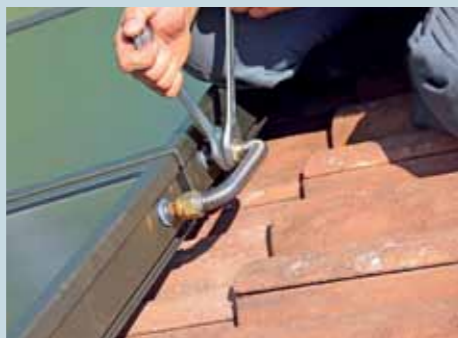
12. Detaillösung bei den Kollektorverbindern: Metallisch dichtende Verschraubungen und ein Edelstahlwellrohr trotz jeder Jahreszeit, ...
