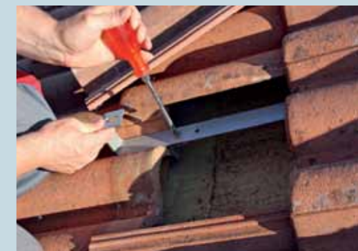
4. Mit Überlappung von einer Daumenlänge liegt der Haken satt auf dem unteren Dachstein auf. Die Klemmverschraubung wird fest angezogen, ...
