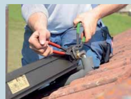
14. Auch die Solarleitung vom Kollektor in den Keller besteht aus einem Edelstahlwellrohr. Mittels Klemmringverschraubung wird der Vorlauf ...
