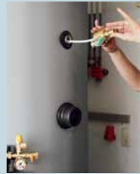
27. Das Brauchwasser wird stets frisch im Durchlaufprinzip erhitzt.
