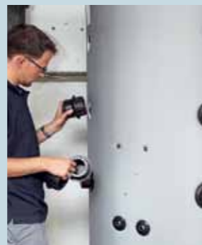
26. ... Wärmeverluste treten an den Anschlüssen auf. Sie werden mit Muffen abgedeckt.
