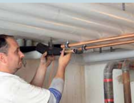
22. Der Heizungsbauer nimmt das Solarwellrohr in Empfang und schließt es an die Kupferrohre, ...
