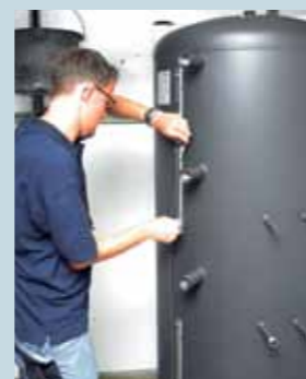
24. Am Aufstellort legt der Monteur verschiedene Fühler an der Speicherklemmleiste an.
