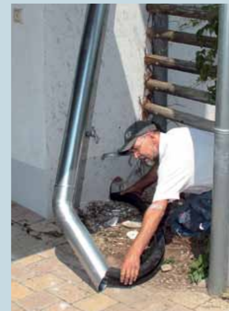
20. ... sodass die Solarleitung aus dem Fallrohr heraus direkt in Deckenhöhe im Versorgungsraum ankommt.
