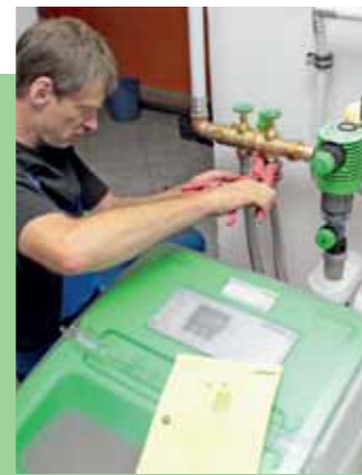
11. ... mit der neuen Wasserleitung. Sobald die Wassermenge in einer der Kammern enthärtet wurde, ...
