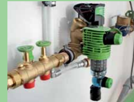
4. Die neu installierte Filtereinheit, rechts die Wasseruhr, oben schwarz das AquaStop-Element.
