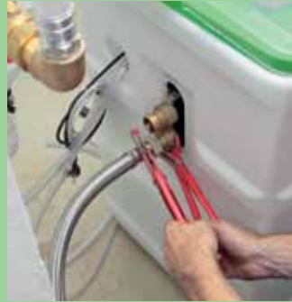
10. Zwei Schläuche verbinden die zwei Kammern („Austauscher“) der Pendel-Enthärtungsanlage ...
