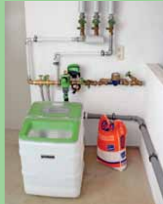
13. Die fachgerecht an die Wasserleitung angeschlossene, noch unbefüllte Enthärtungsanlage.
