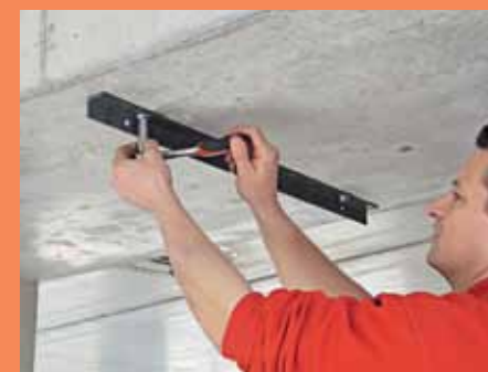
15. An einem sicher mit der Betondecke verankerten Winkeleisen aus Stahl wird die ...
