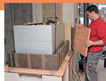
18. Als innere Verkleidung werden kleinere hochspeicherfähige Magnesit-Formsteine verbaut, die Außenhülle besteht aus großformatigen Schwerschamotte-Putzträgerplatten.
