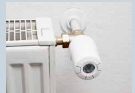
12. Montierter Funkthermostat am Bestandsheizkörper. Dieser kann dann konventionell oder über ein zentrales Bedienteil geregelt werden.
