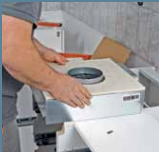
A. Mit Schwertschaummatten wird die Umlufteinheit schallgedämmt.
