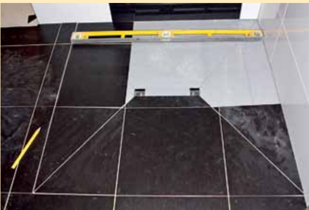
18. ... zum mittigen Line-Ablauf ist dabei durch das Board ganz automatisch schon vorgegeben.
