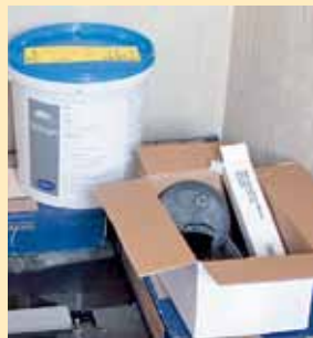
14. Das Dichtset aus Pulver- und Flüssigkomponente, Dichtband und -Ecken steht für den Fliesenleger schon bereit.
