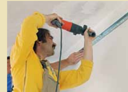
4. Zur Montage der Profile werden alle 50 cm Dübellöcher in die Wand gebohrt, ...
