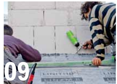
Zwischen Schornstein und Dämmung wird die Fuge ausgeschäumt, um Wärmebrücken zu minimieren. Der luftdichte Anschluss ...
