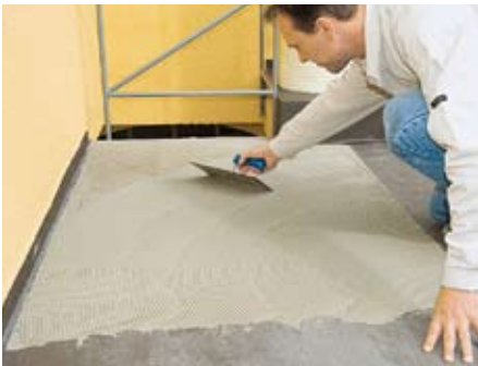
4. Danach wird Flexmörtel in Rollenmattenbreite gleichmäßig auf die Bodenfläche aufgetragen und durchgekämmt.
