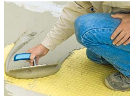
9. Beim Verlegen der Fliesen wird Flex-Fliesenkleber durchs Gitternetz in die Vertiefungen gedrückt und per Kammspachtel abgezogen.
