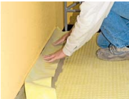
7. ... wird ein 150 mm breites Dichtband (Dura-base WP) geklebt. Mit demselben Band werden auch die Wandanschlüsse abgedichtet.
