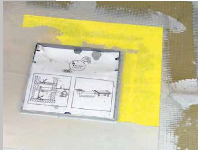
7. Gerade auch um den Pumpenschacht herum ist darauf zu achten, dass alle Anschlüsse und Fugen sorgfältig abgedichtet sind. Hier wird dann zusätzlich ein spezielles Vlies sowie eine Dichtungsmasse verarbeitet.
