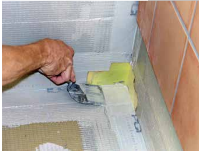
6. Wie sonst auch üblich bei gefliesten Duschböden wird der gesamte Duschbodenbereich abgedichtet. Zuerst werden die Wandwinkel und Eckteile eingeklebt, dann werden die Flächen noch einmal überstrichen.
