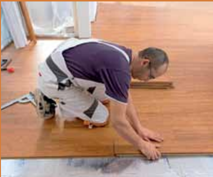
12. Wenn genügend Fläche verlegt ist, empfiehlt sich das Arbeiten von der fertigen Fläche aus. So hat man den Kopfnahmverschluss gut im Blick.
