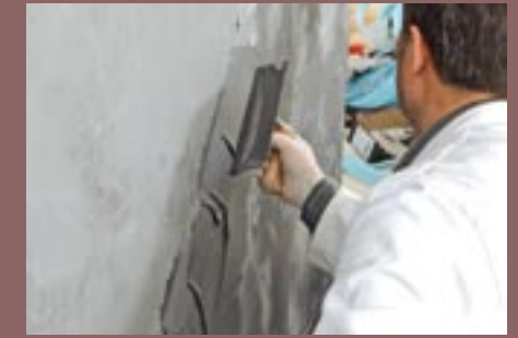
18. Das Material nun in gleicher Weise auftragen und dabei die Aufziehrichtung stets variieren.
