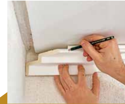
9 ... anstückeln. Hier fehlten zirka 15 cm bis zum Raumeck. An einem auf Innengehrung gesägten Stück wird dann die Länge markiert.
