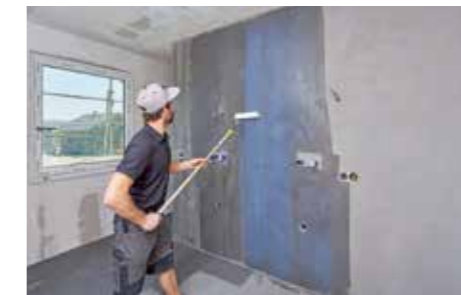
18 ... sodass auch hier parallel zum Boden die Imprägnierung aufgetragen werden kann. Anschließend kann alles in Ruhe trocknen.
