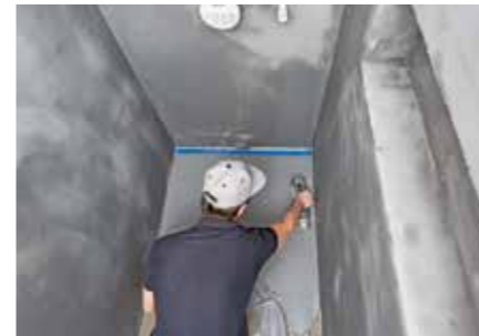
12 Ebenso wieder ganz hinten beginnend folgt nun die Spachtelung der Bodenfläche. Das cremige Material lässt sich gut verteilen und unter leichtem Druck abziehen.
