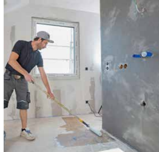
11 In einem Arbeitsgang arbeitet man sich dann bis in den Hauptraum vor und rollt den zuvor entstaubten Boden – hier ein Trockenestreich – gleichmäßig ab.
