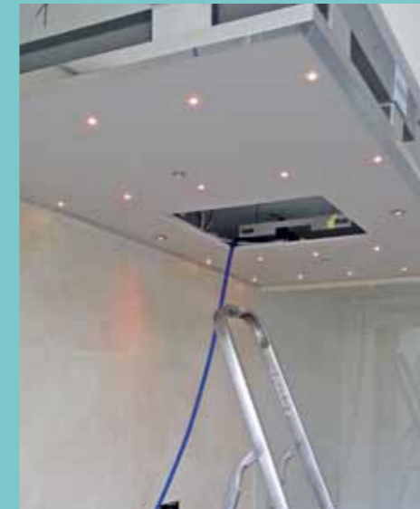
8. Ebenfalls in der Kabinendecke integriert ist ein LED-Sternenhimmel, allerdings nicht in freier, sondern in gerasterter Anordnung.
