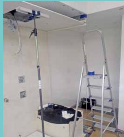
7. In einer abgehängten Platten-Konstruktion ist dann auch der Regenhimmel integriert. Hier ist dann auch schon die erste Glasscheibe seitlich montiert.
