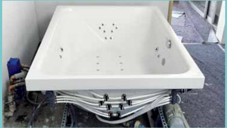
10. Die Wanne wurde werkseitig mit individuell platzierten Düsen und Licht bestückt. Vor Ort galt es dann, sie exakt auszurichten und anzuschließen sowie mit der Pumpentechnik auszustatten.
