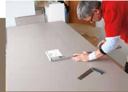
5. Beide Arbeitsplatten müssen dann maßgenau in den Raumwinkel passen. Hier wird die Ausklinkung an der Kochfeldplatte angezeichnet ...
