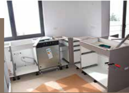
3. Die Fensterunterkante gibt die Einbauhöhe vor. Die Möbelfüße werden so weit hochgeschraubt, bis die Korpusoberkante bündig ist.
