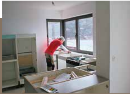
1. Im vorgesehenen Küchenbereich werden die vormontierten Korpusse zur Zeile aufgestellt und ausgerichtet. Links die Geräteschränke.
