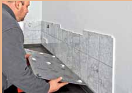
23. Im Kochbereich dient eine punktförmig angeklebte Edelstahlplatte als Spritzschutz.
