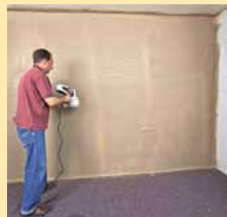
17. Falls es an manchen Stellen noch Unregelmäßigkeiten geben sollte, einfach nochmals fein dosiert bzw. partiell nachsprühen.
