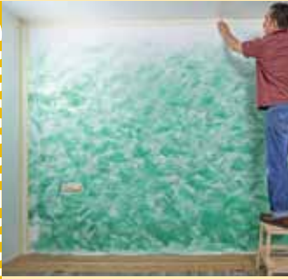
1. Die Wand mit ihrer etwas verunglückten Wischoptik soll nun eine völlig neue Anmutung bekommen.
