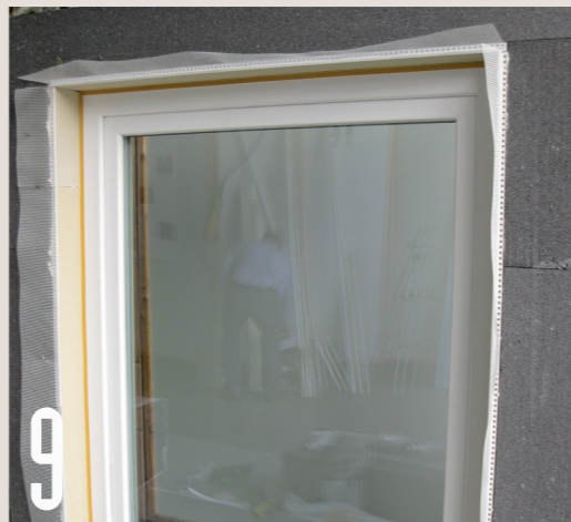
9 Die Gewebestreifen dienen der Armierung bzw. Rissicherung des Putzes und werden später eingespachtelt.
