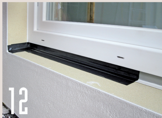
12 Es besteht aus vorgeformten Eckteilen und Dichtbandwinkeln, die entlang bzw. unterhalb des Fensterrahmens am Fensteranschlussprofil angebracht werden.
