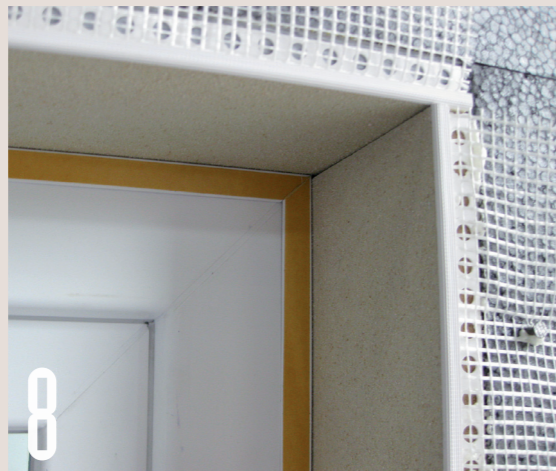
8 Damit ist die Laibung sauber ausgebildet und der Fensteranschluss dicht. Das vordere Kantenabschlussprofil trägt einen Gewebestreifen, den man auf der Dämmung fixiert.
