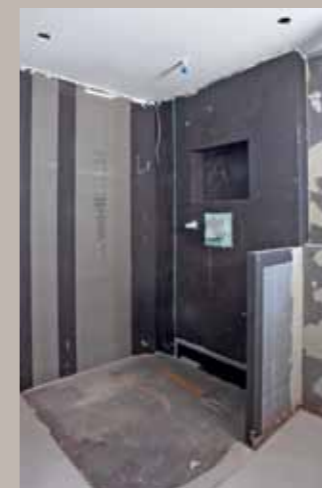
10. Die Eckdusche im Plattenroh-zustand, die Duschbodenfläche sitzt nun bündig mit dem Estrich.
