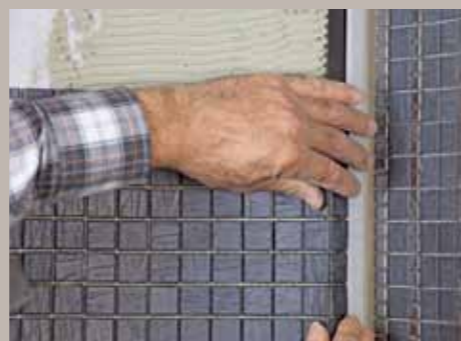
17. Sie können auch gut über Eck verlegt werden, wie hier an der Kante zur versenkten LED-Schiene.
