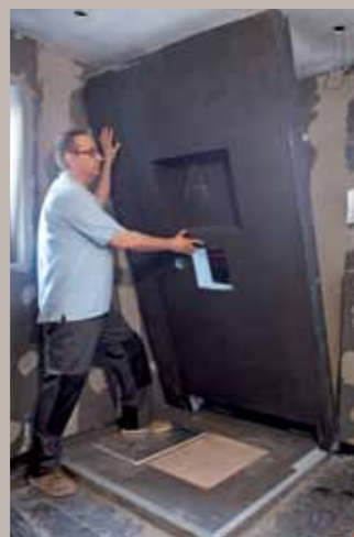
6. Das Duschelement beinhaltet die Nische sowie die Aussparungen für die Armatur und den Wandablauf.
