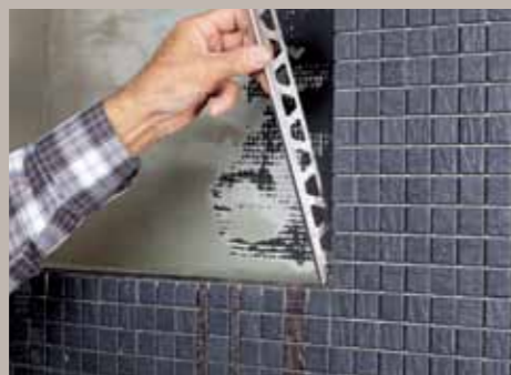
18. Für einen dekorativen Abschluss an der Nische hat man rundum Edelstahlleckeprofile eingesetzt.
