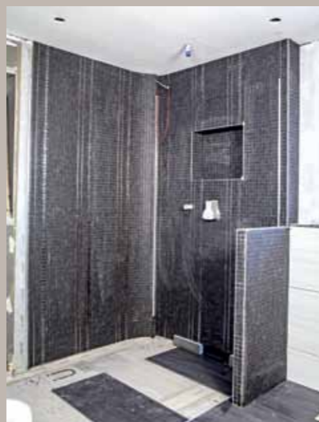
21. Auf dem Boden wurden großformatige Fliesen aus derselben Keramikserie verlegt. Dank des gleichmäßigen Gefälles hin zum Wandablauf konnte man unschöne Fliesenschnitte vermeiden.
