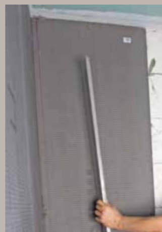
3. Nun vollflächig die Platten ansetzen, mit einem Richtscheit festdrücken und senkrecht ausrichten.
