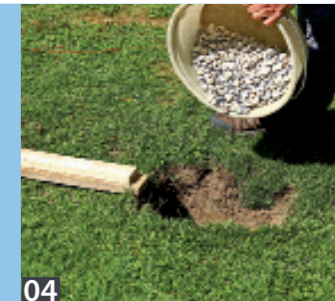
04 Bodenabstandsplatte auslegen und so viel Kies einfüllen, dass das Tor auf der Latte aufliegt und der Pfosten auf dem Kies steht.
