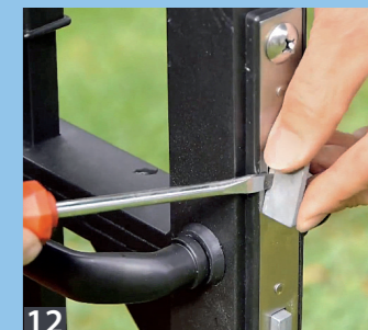
12 Nach dem Montieren des Türdrückers kann der Schlosskasten gelöst werden. So lässt sich der Schließzylinder leichter einsetzen.
